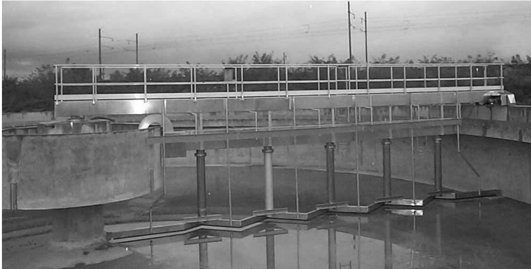
Figure 14 : Clarificateur à pont suceur
