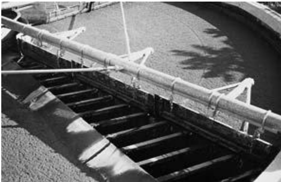
Figure 22 : Etape d'épaississement des boues par flottation
