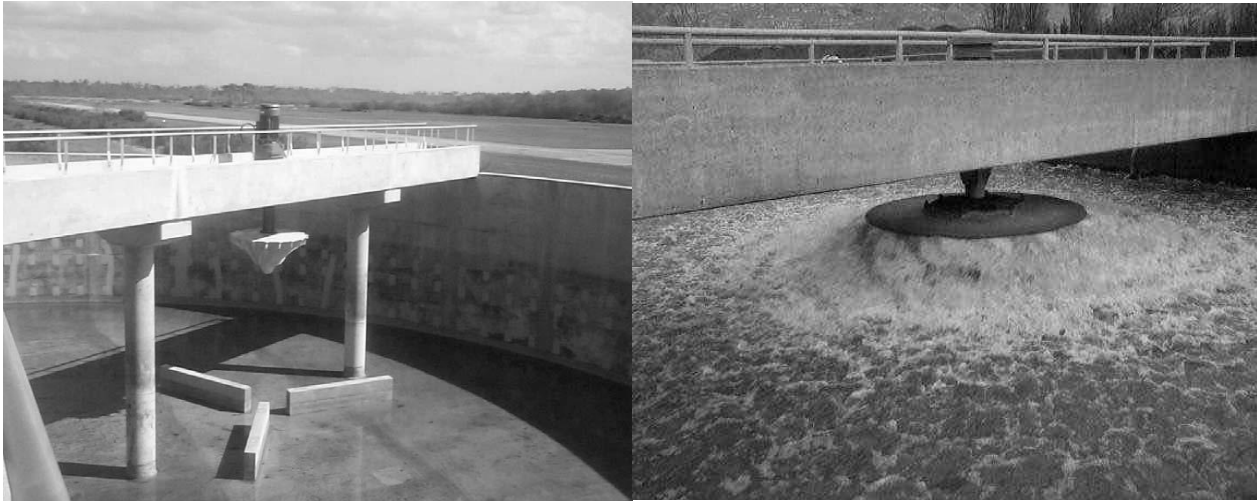
Figure 10 : Bassin aéré mécaniquement par des turbines de surfaces
